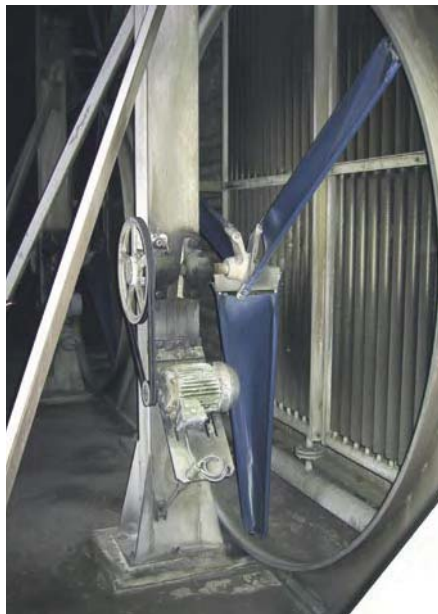
Ventilatoren in den Trockenkammern: Drehzahlregulierung spart 24 % Energie.
