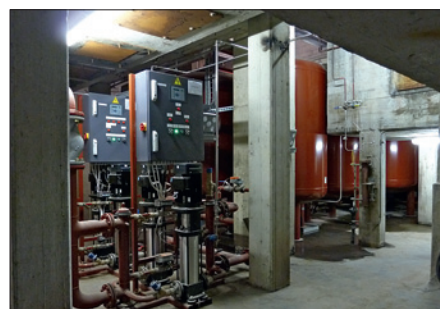
Druckhaltestationen mit Pumpen-druckhaltung, Expansionsbehälter.
