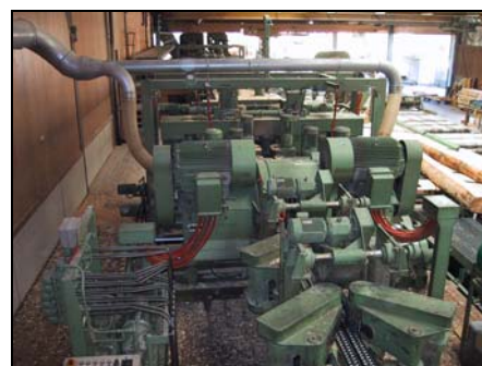
Motoren laufen häufig im Leerlauf. Ein bedarfsabhängiges Schalten lohnt sich.
