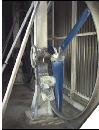
Ventilatoren in den Trockenkammern: Drehzahlregulierung spart 24% Energie.
